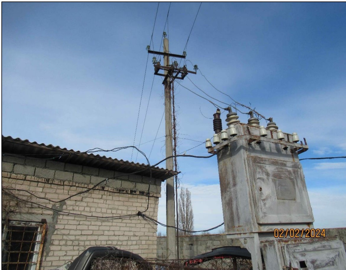
Опора №3/11 ВЛ 10 кВ Ф-227
