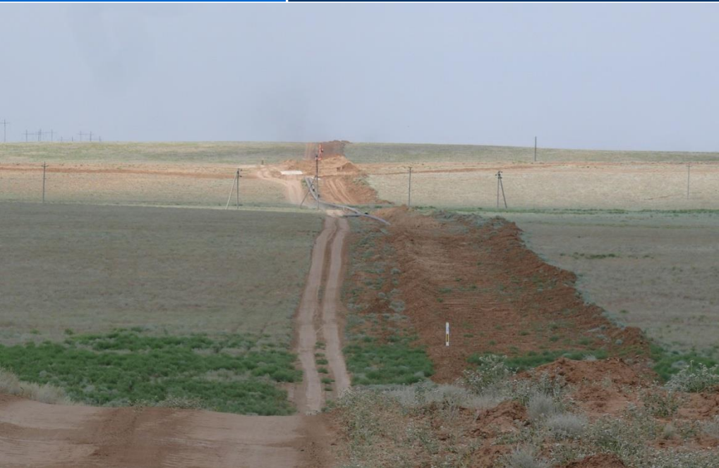
Линейная часть магистрального газопровода
